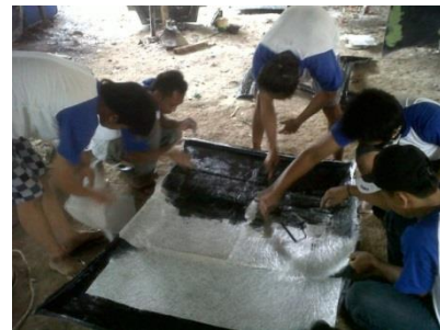
Gambar 3 Pekerja di IKM Fiberglass bekerja tanpa alat pelindung
