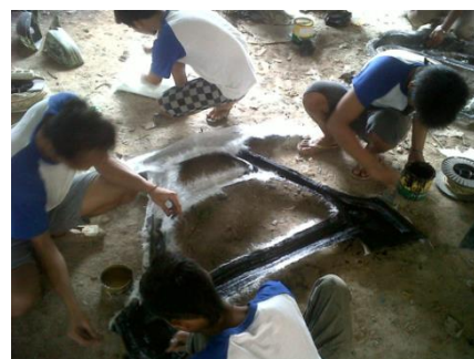
Gambar 4 Pengerjaan Fiberglass di IKM tanpa alat keselamatan yang memadai
